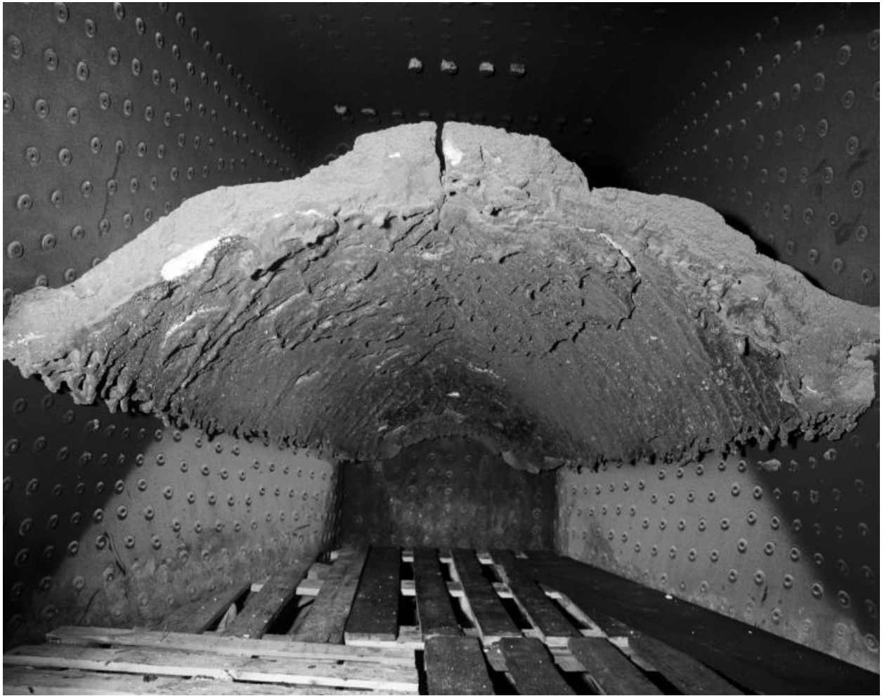
Locomotive, vue intérieure de la chaudière, détail du foyer, voûte monobloc en béton, plaques tubulaires (au fond) et entretoises.
