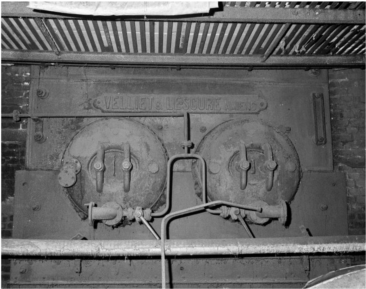
Niveau inférieur, vue des portes d'accès aux bouilleurs surmontées de la plaque signalétique portant le nom du constructeur.
