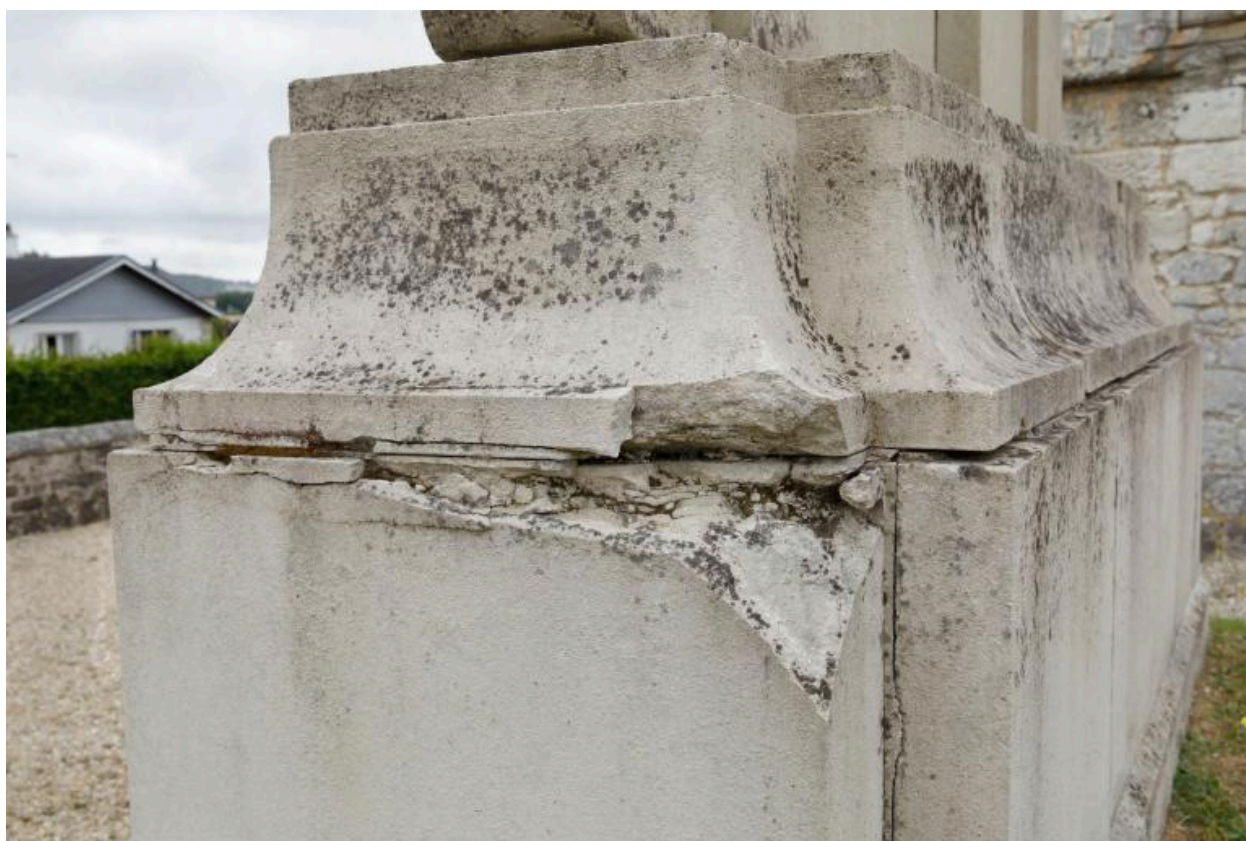
Altérations du piédestal et de la base de la stèle, détail.
