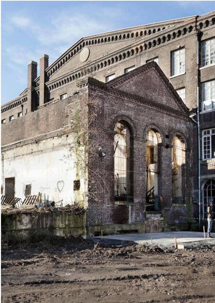
Vue du pignon Nord de la salle des machines attenante à la façade Est de la filature.
