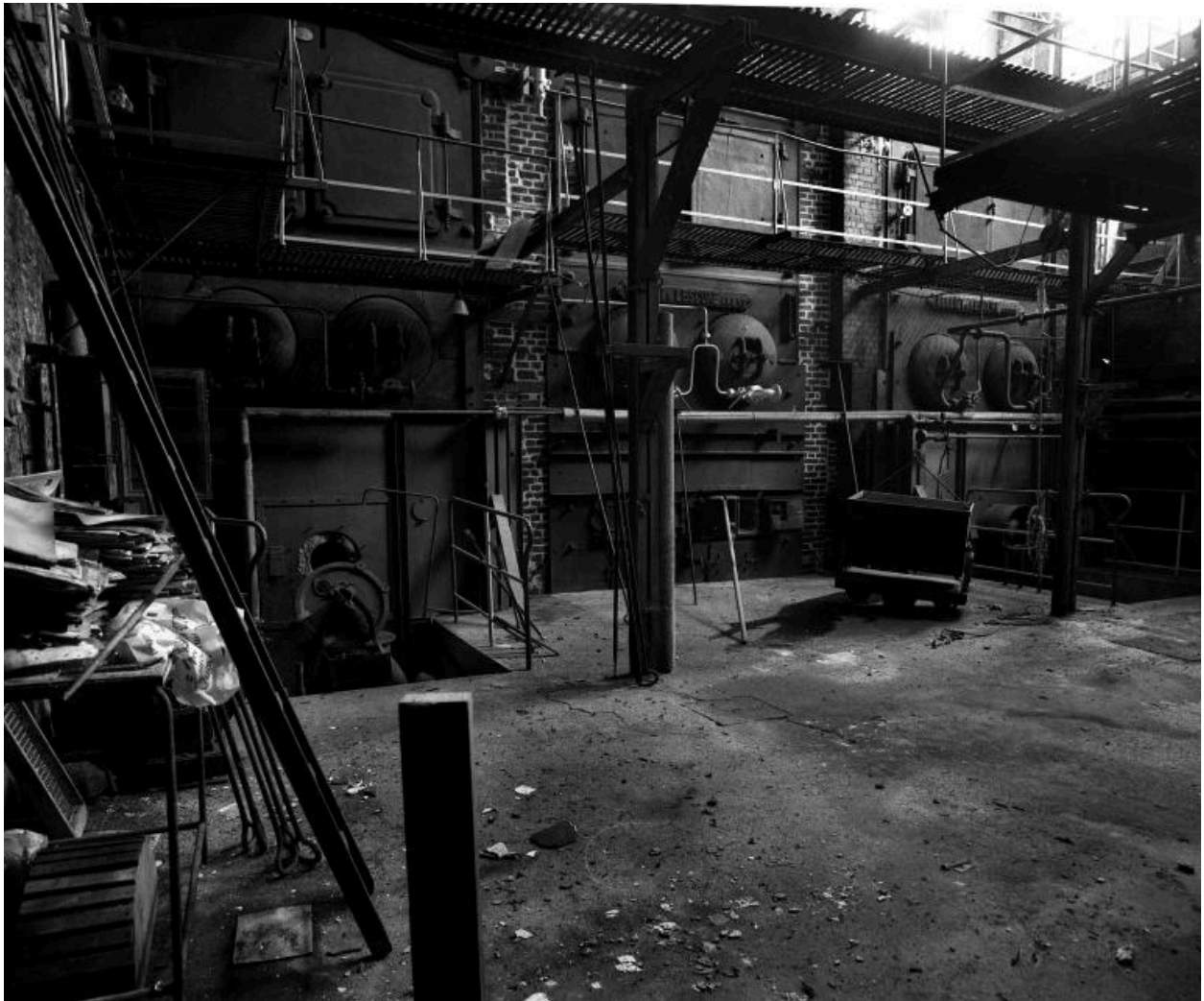
Niveaux inférieur et intermédiaire, vue d'ensemble des trois chaudières.
