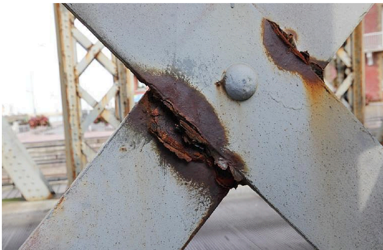
Détail de corrosion.
