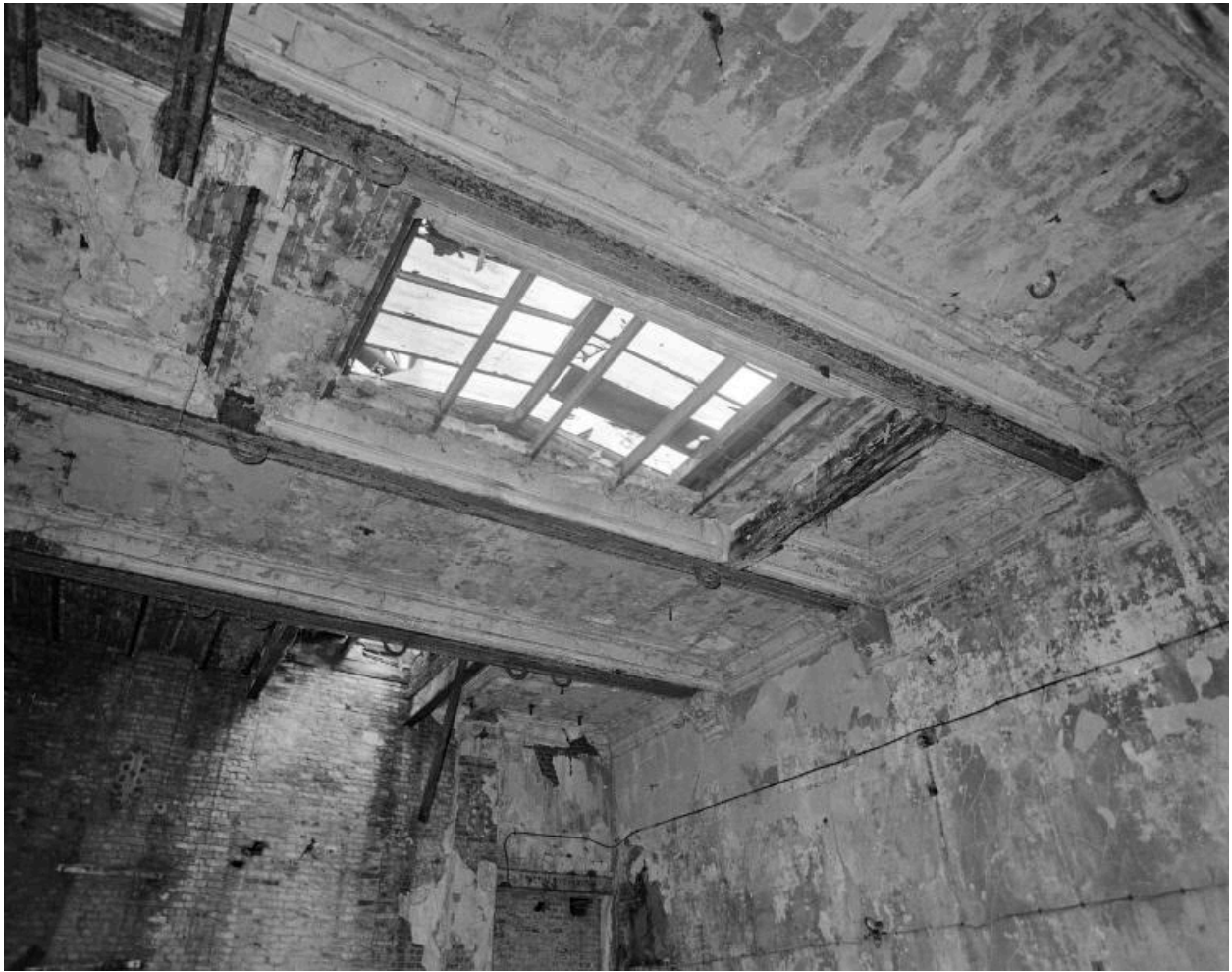
Salle des machines, vue intérieure.
