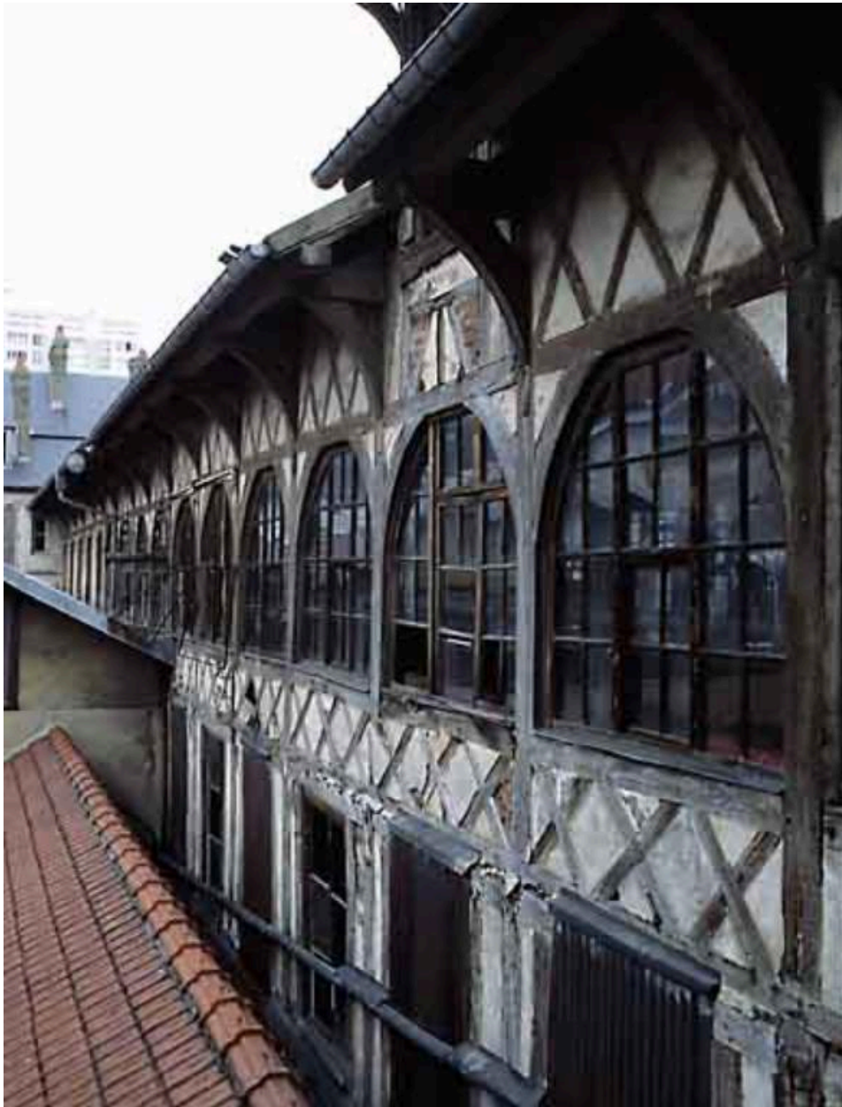
Vue du tissage (bâtiment Nord), façade sud sur cour intérieure couverte, détail du niveau supérieur.
