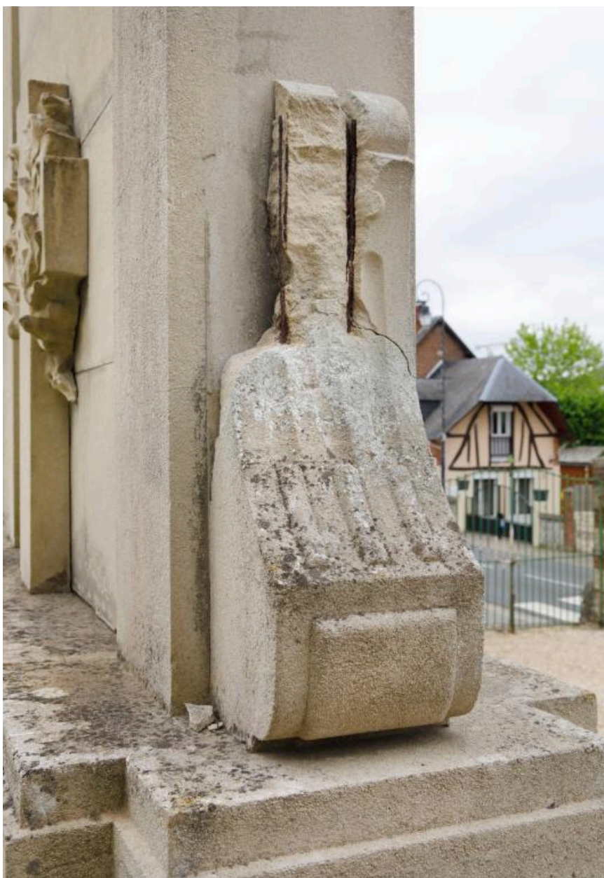
Aileron gauche, détail des altérations de la pierre artificielle.
