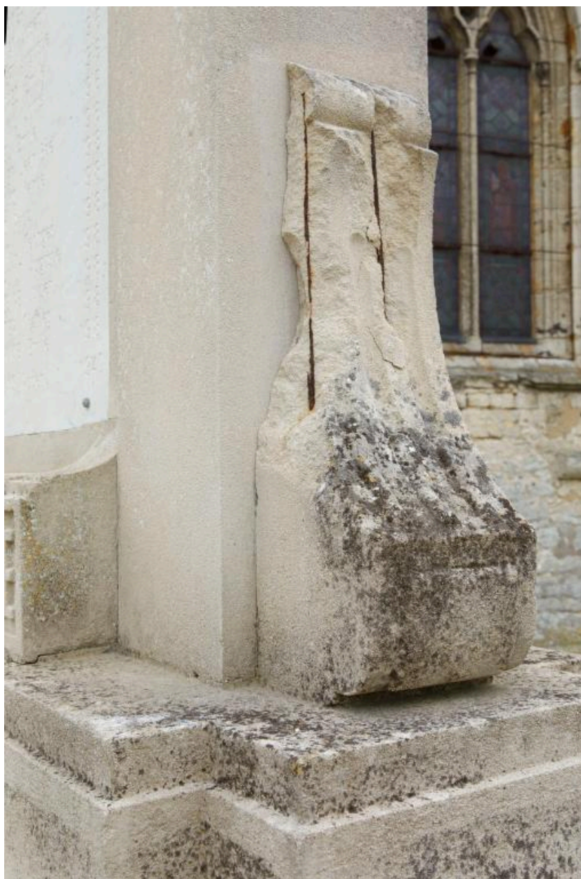
Aileron droit, détail des altérations de la pierre artificielle.
